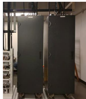
Apparecchiatura CBTC lungo i binari
